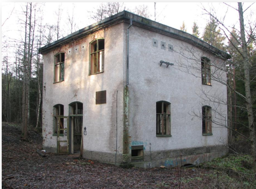
Ovan: Brännebro kraftverk, ett "tomt skal". (Foto från 2007: Richard Edlund, Kalmar läns museum)
