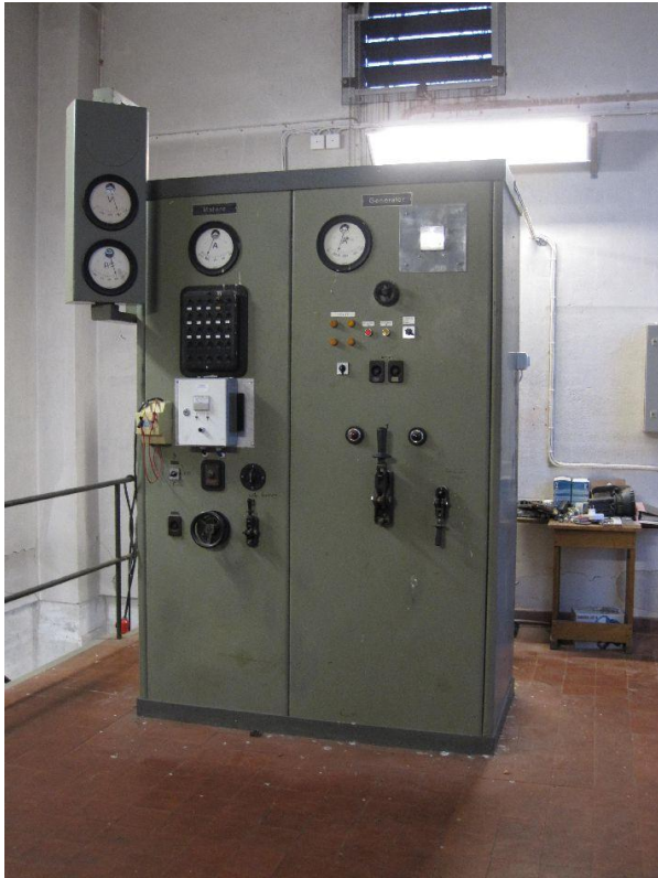
Ursprungligt kontrollskåp, fortfarande i drift.
