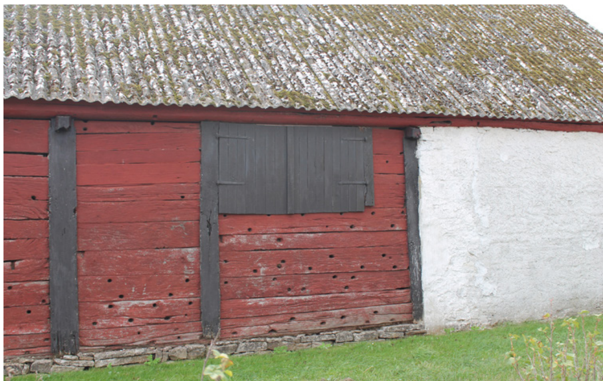
Här möts de två vanligaste väggtyperna; skiftesverk och kalksten. Stenbyggnaden har rappats och skiftesverksväggen försetts med lufthål. Stenåsa by och socken
