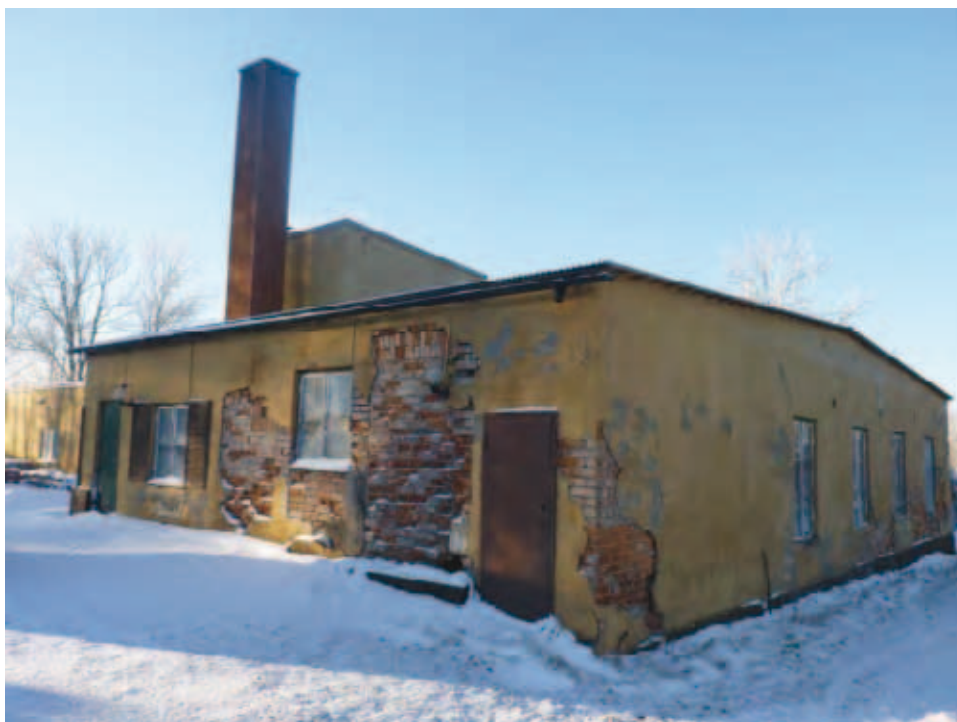
Figur 88. Verkstad vid Kungsstenen med omfattande putsbortfall.
