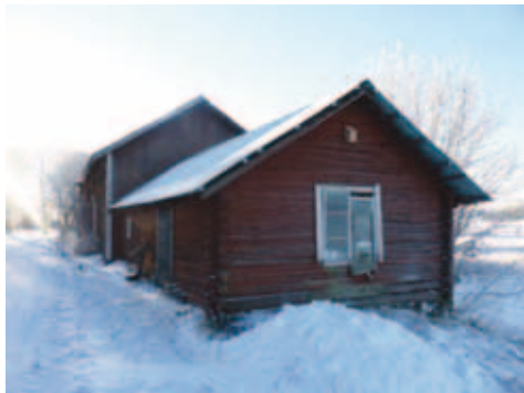
Figur 114. Äldre ekonomibygnad med utknutar med kraftigt rötskadat timmer.
