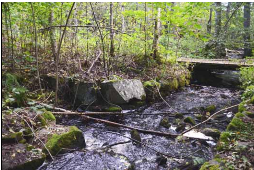
Figur 232. Stenskodd vattenränna nedströms dammvallen (Västervåla 43:1). Notera husgrund på motsatt bäcksida. Foto mot sydöst.
