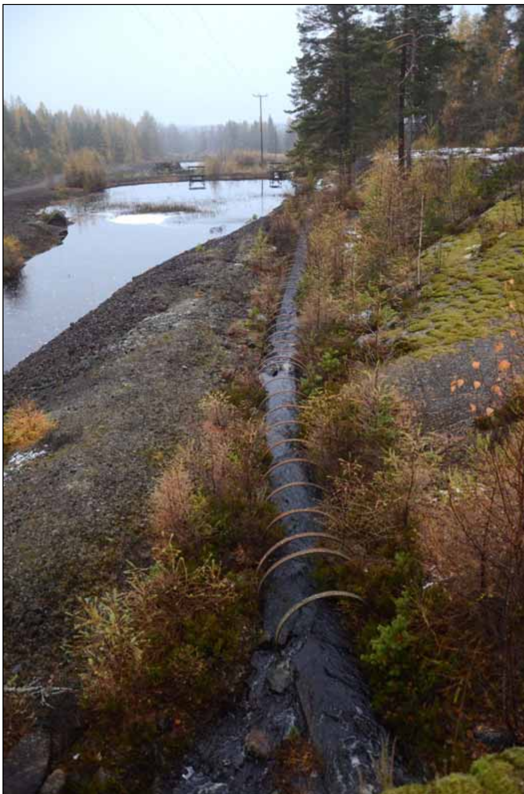
Figur 118. Rester av trätub från övre dammen till kraftstation. Foto mot söder.
