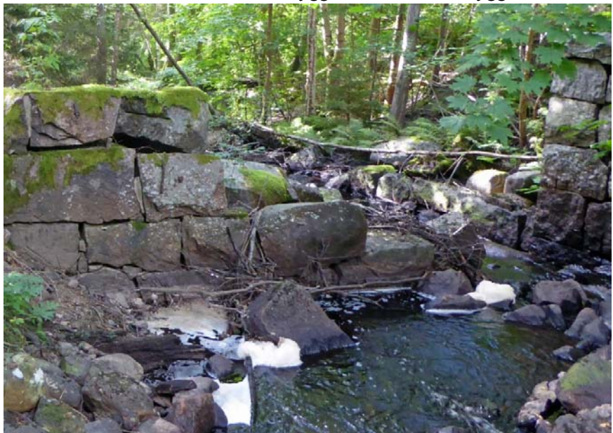
Figur 32. Norra sidan av dammvallen med utskovet synligt till höger. Foto taget från NÖ.
