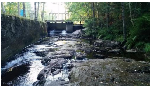
Bild 12. Nedströms damms damm i Hammarskogsån. Den gjutna Erikakanalen till vänster i bild. Foto: Länsstyrelsen Örebro.
