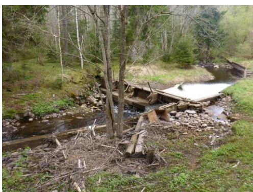
Bild 8. Den mindre dammen som var belägen strax uppströms Kronohyttan. Innan åtgärd. Foto: Länsstyrelsen Örebro.
