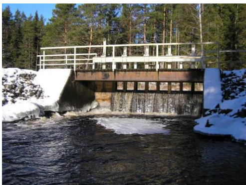
Bild 21. Dammen vid Gränstjärn innan åtgärd. Foto: Stefan Helsing.
