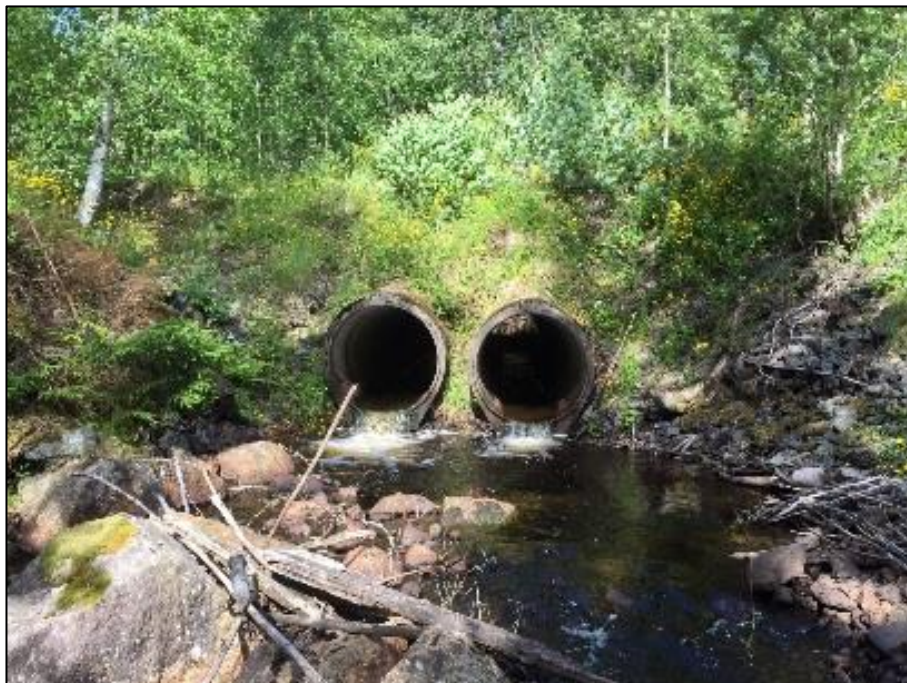
Vägtrumma som kan utgöra vandringshinder för fisk, vid Ekebergshyttan i Allmosaälven.
