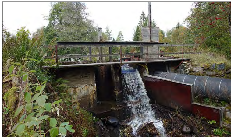
Figur 9. Damm 490, Kanaldammen ligger vid Silverhyttan intill Trösälven i Karlskoga socken och är en verksdamm till ett kraftverk. Vattnet leds i ett turbinrör.
