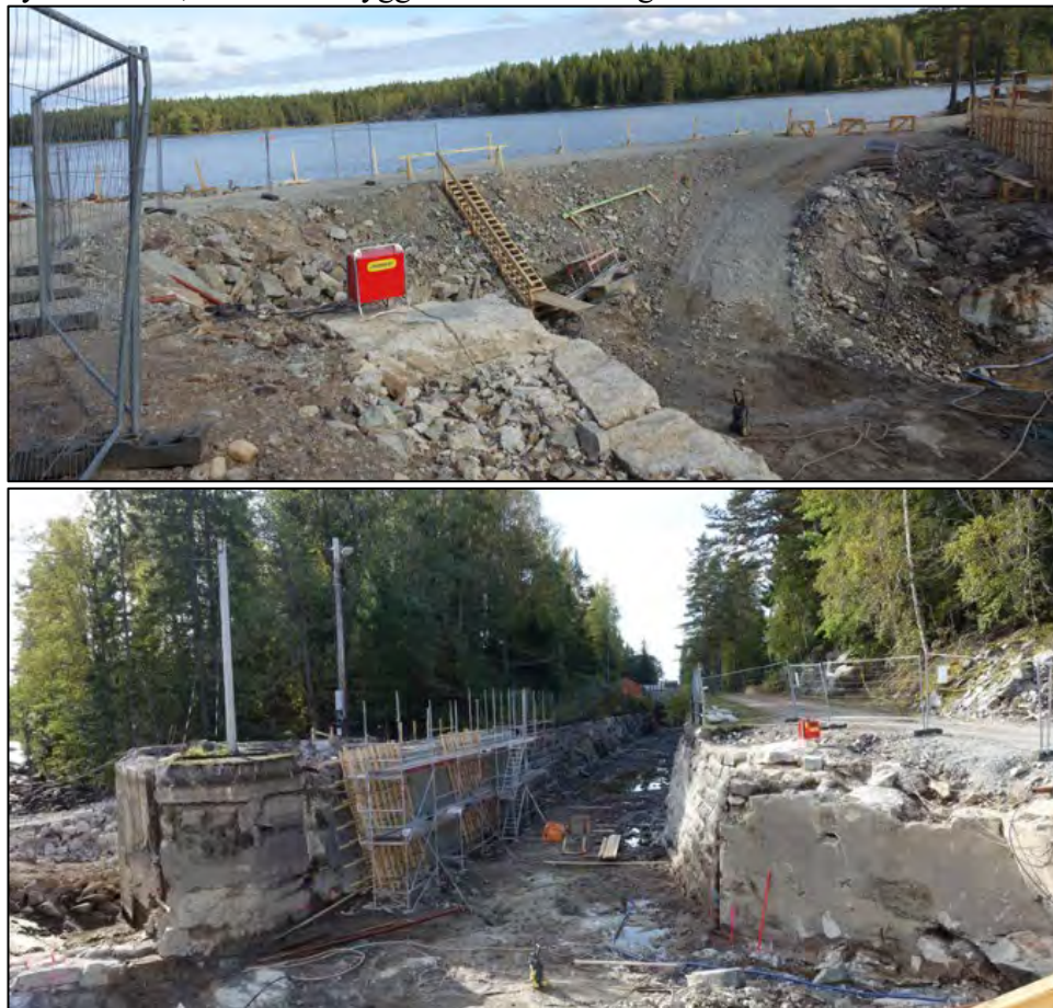
Figur 22. Damm 263, Västgöthyttfors verksdamm. Övre bilden visar den provisoriska dammen under renoveringsarbetet år 2019. Den nedre bilden visar en öppning till vänster som är den naturliga vattenleden. Öppningen i mitten är en grävd kanal som leder till kraftverket.
