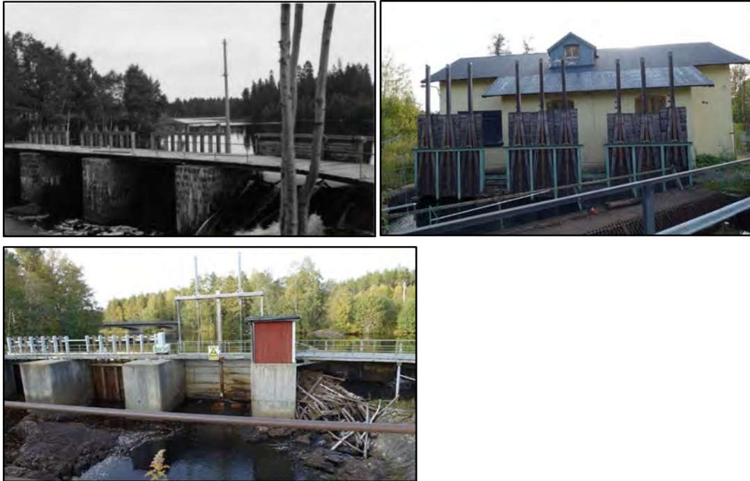
Figur 8. Damm 332, Hammarn kraftverksdamm på 1950-talet och år 2019. Viss likhet finns men pelarna av slaggtegel är numera gjutna av betong.
