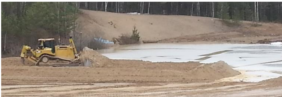
Figur 6. Påbörjat arbete med att schakta igen det vattenfyllda grustaget. Foto: Länsstyrelsen Örebro.
