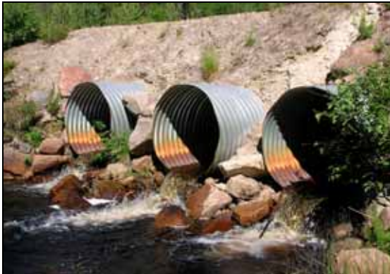
Figur 8. Vägtrummor som utgör partiellt vandringshinder för öring (definitivt för mört).
