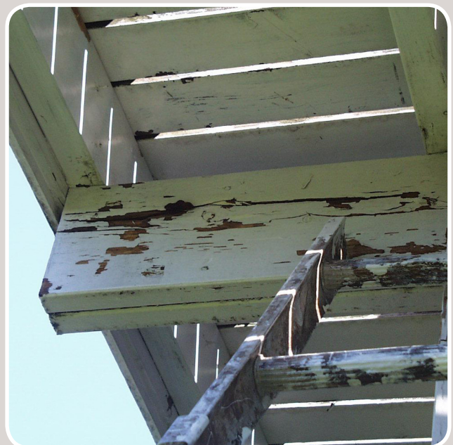
Flagad färg på takregel, Foto: MYCOTEAM
