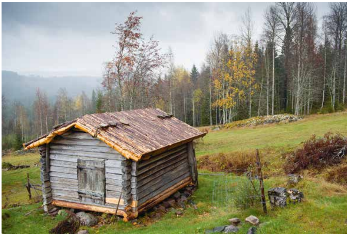
Nylagt farjtak på en lada i Lekvattnet. Ägarna har tillsammans med hantverkare jobbat hårt för att nå detta fina resultat. Då taket lades arrangerades också en takläggningkurs med stöd av Länsstyrelsen i Värmland.
