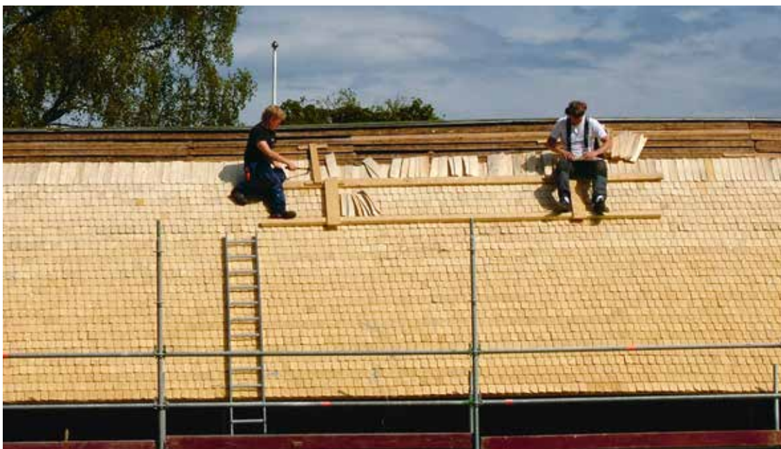
Nytt tak läggs på en ladugårdslänga på Finnskogen. Varv efter varv spikas stickorna i en trelagstäckning.
