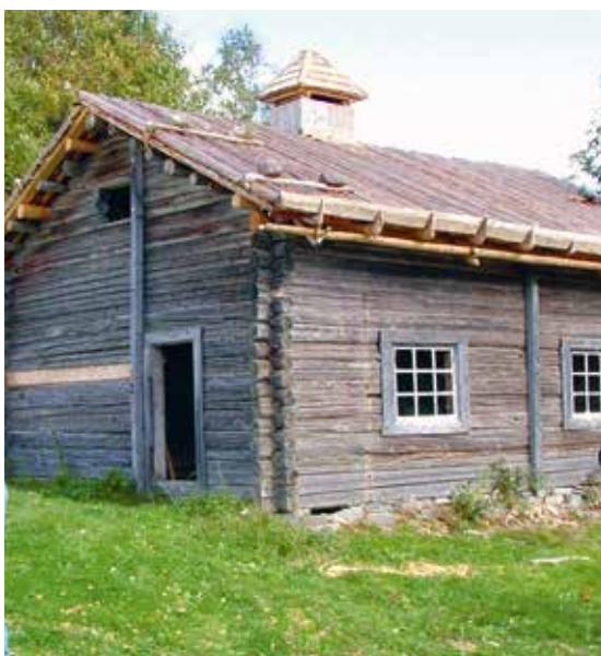
Ett nylagt farjtak på en bastu i Brandval finnskog, Norge. Här har även en hänggränna i trä monterats. Se byggnadens unika ugn på sidan 38.
