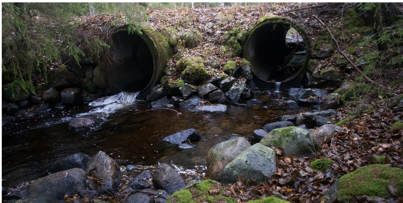
Fellagda vägtrummor kan utgöra vandringshinder. De behöver i så fall läggas om så att det är tillräckligt djupt (minst 15 cm), tillräckligt långsamt flöde (max 1 meter per sekund), inga vattenfall, och grus och sten på botten. Foto: Anders Tedeholm
