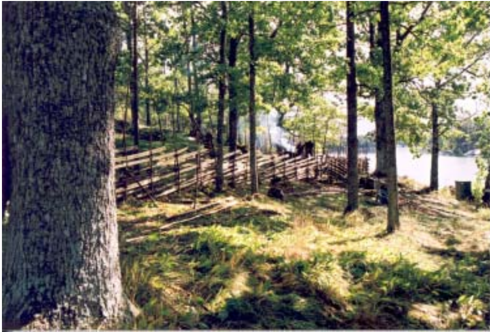
En nybyggd trögärdesgård av rosagstyp i ene och granvirke utmed en historisk hägnadssträckning.
