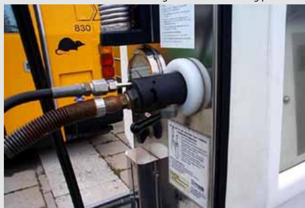
Biogastank. Foto: Bioenergiportalen.se
