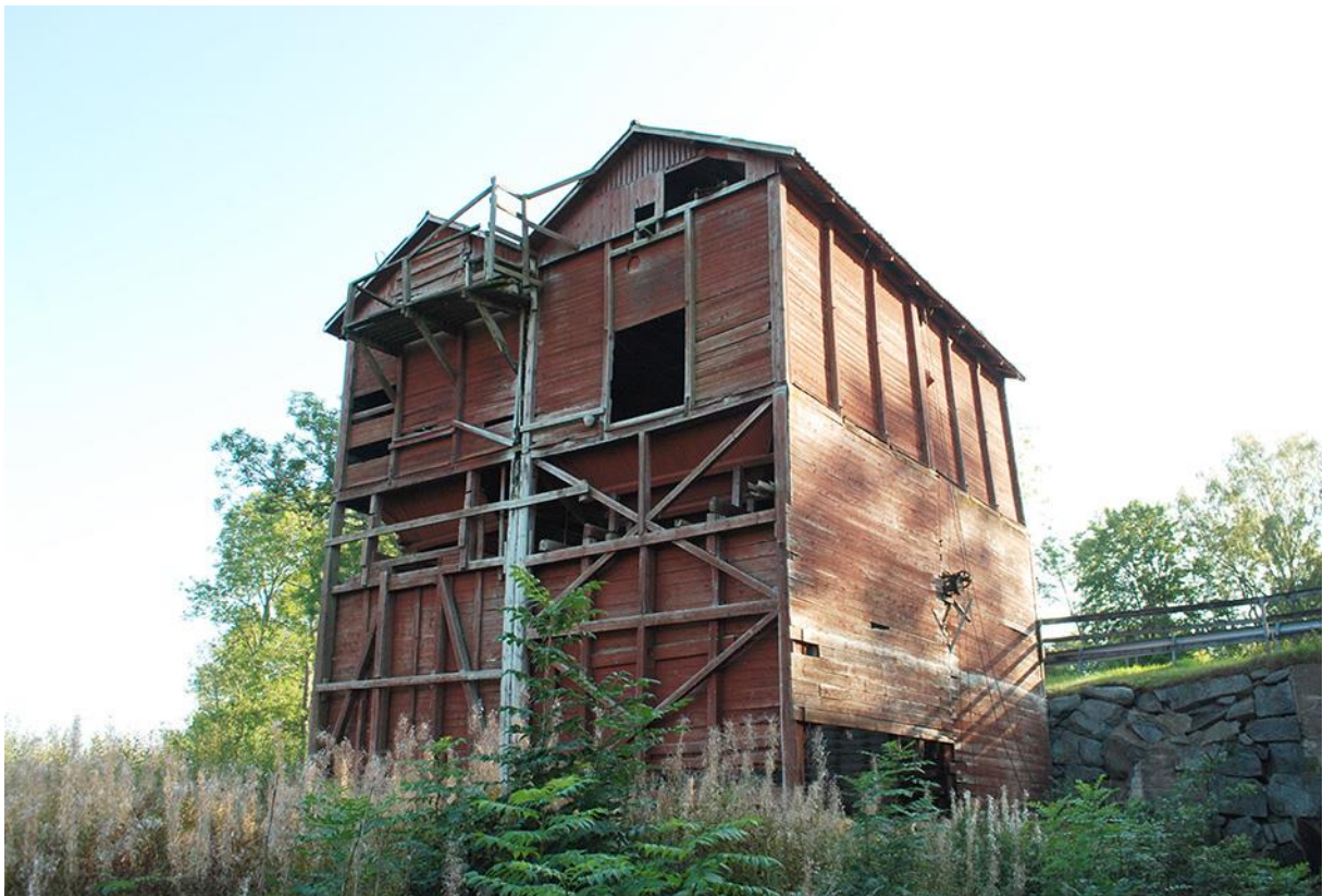
Rötskadorna är på sina ställen stora vilket har orsakat sättningar så att byggnadens två delar börjar glida isär. Foto LKU 2014
