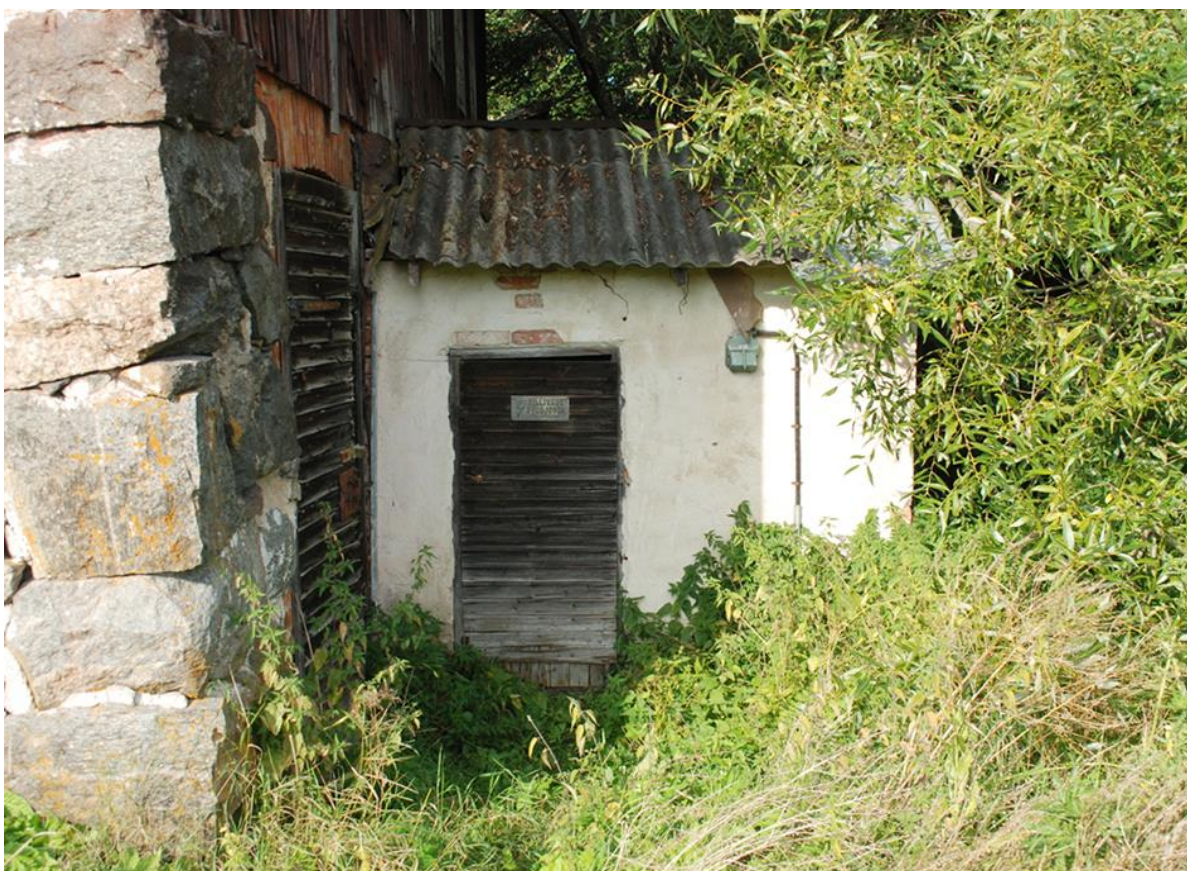
Utanför kvarnen på nedströmssidan finns en transformatorstation med en stor ASEA-transformator vars tillverkningsskylt inte går att se. På väggen sitter en varningsskylt med texten "växelström 380/220 volt". Foto LKU 2014
