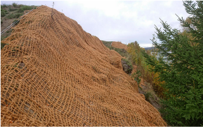
Kokosfibrer och insådda gräsfrön ska hjälpa till att skapa ett varaktigt växttäckte som hindrar fortsatt erosion av lämningarna efter fogdeborgen. Foto: Västernorrlands Museum.
