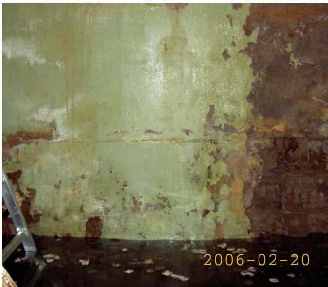
65. Bassäng nya reningsverket
