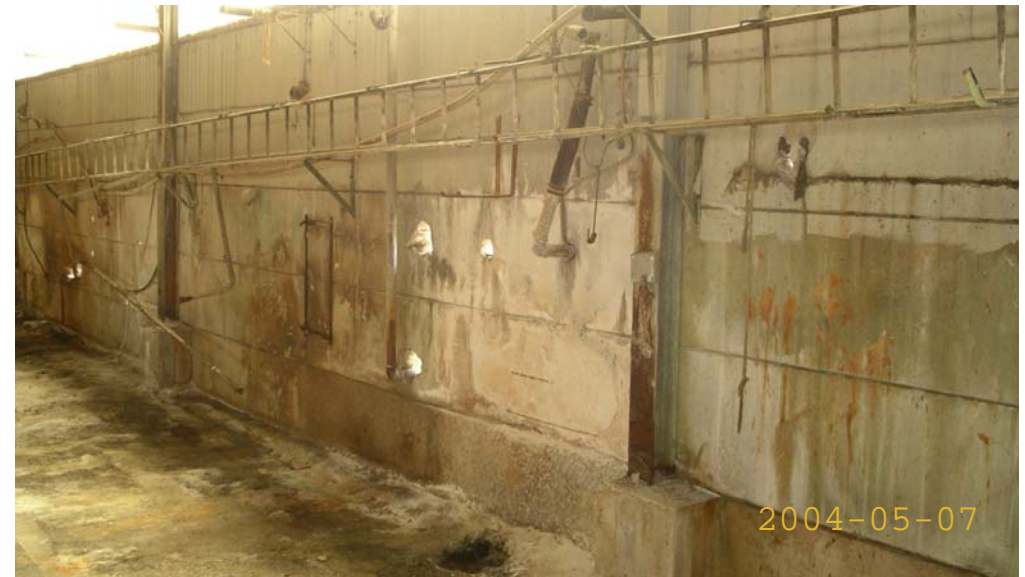
52. Östra väggen industribyggnad
