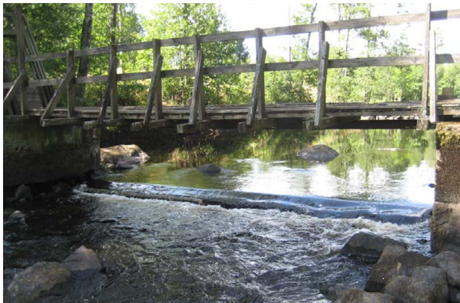
Fig 41. Resterna av det fasta fisket vid Petersborg. Bron är idag i mycket dåligt skick. Den främre kanten på utskovet utgör idag ett onödigt hinder för arter som ska vandra uppströms vid lågvattenföring.
