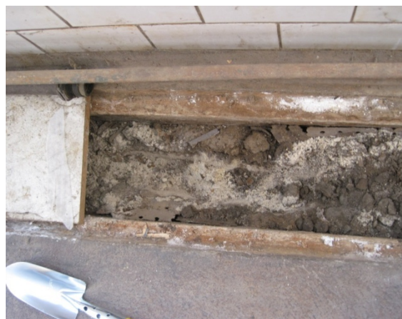
Figur 7 Rännan från den tidigare verksamheten
