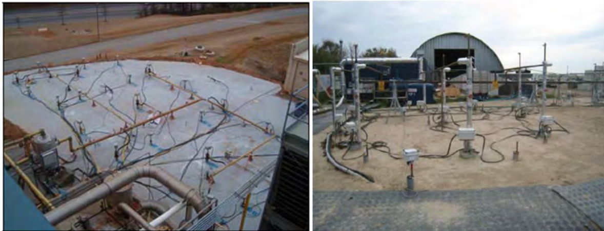
Figur 14. Foto på en termisk sanering. Betongkappa och uppsamling av ångor. Till vänster foto från TerraTherm från ett projekt i USA och till höger ett foto från ett projekt i Danmark (foto Structor).
