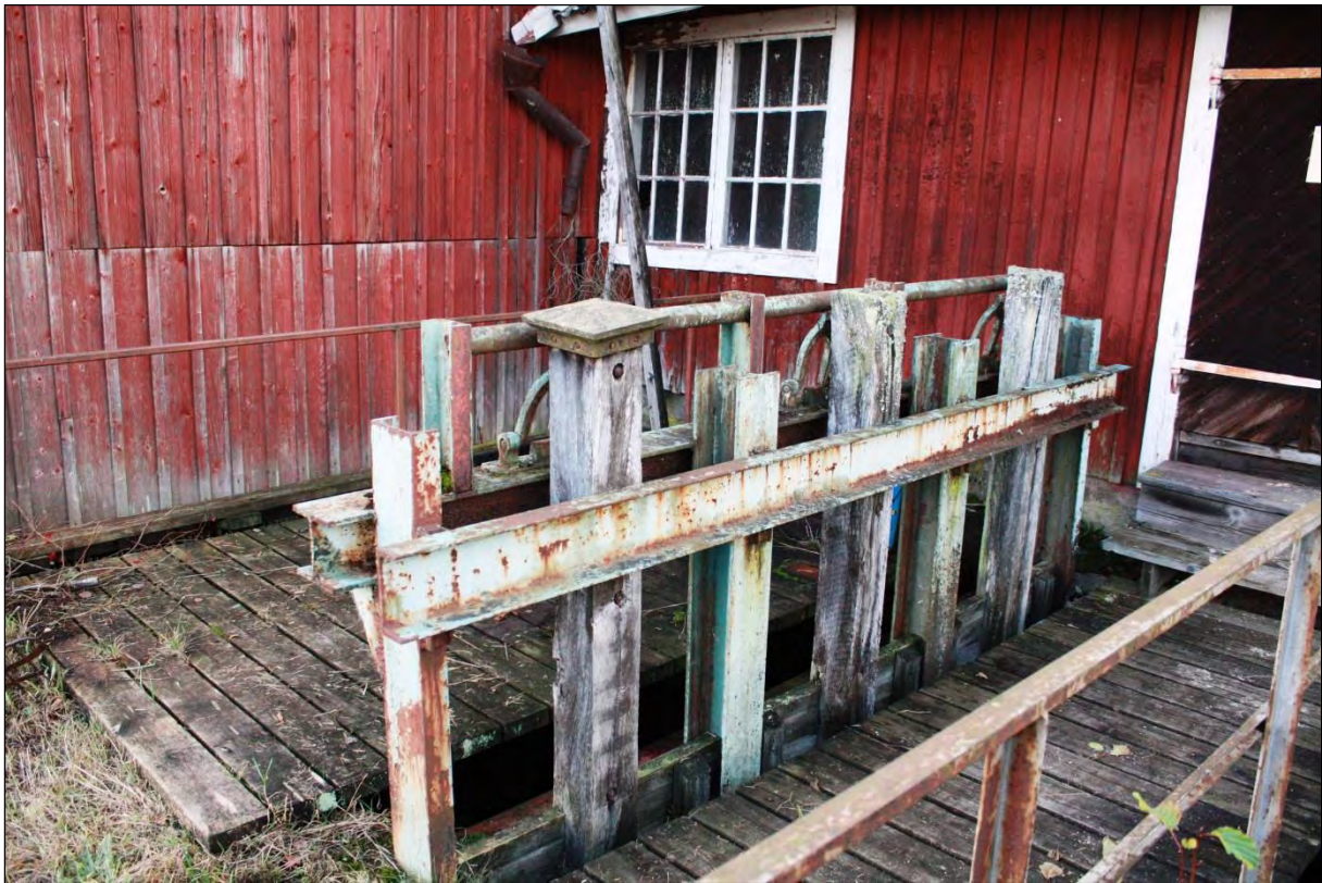
Bild 12. Intaget till sågens turbin.
