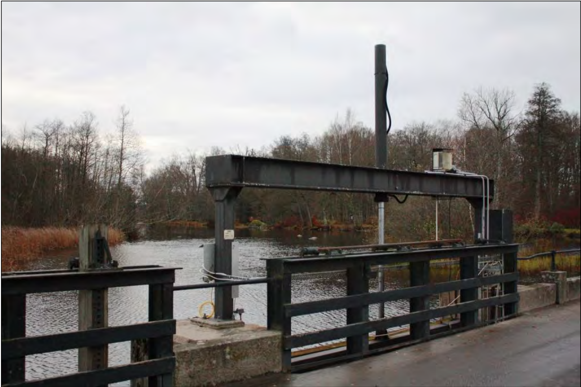
Bild 7. Automatiserad utskovslucka som reglerar vattenflödet till kraftstationen.
