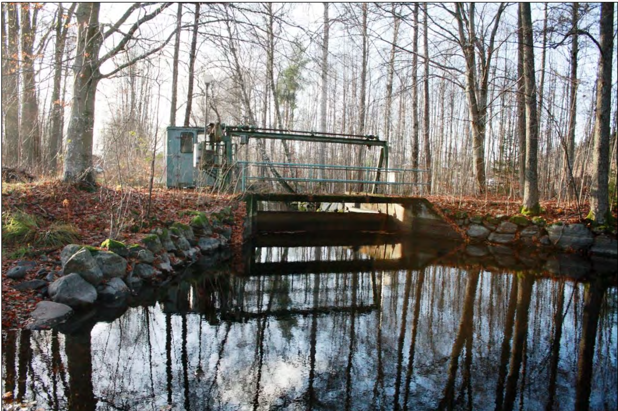
Bild 13 & 14. Utskov som reglerar intaget till kanalen som leder bort mot kvarnhuset.
