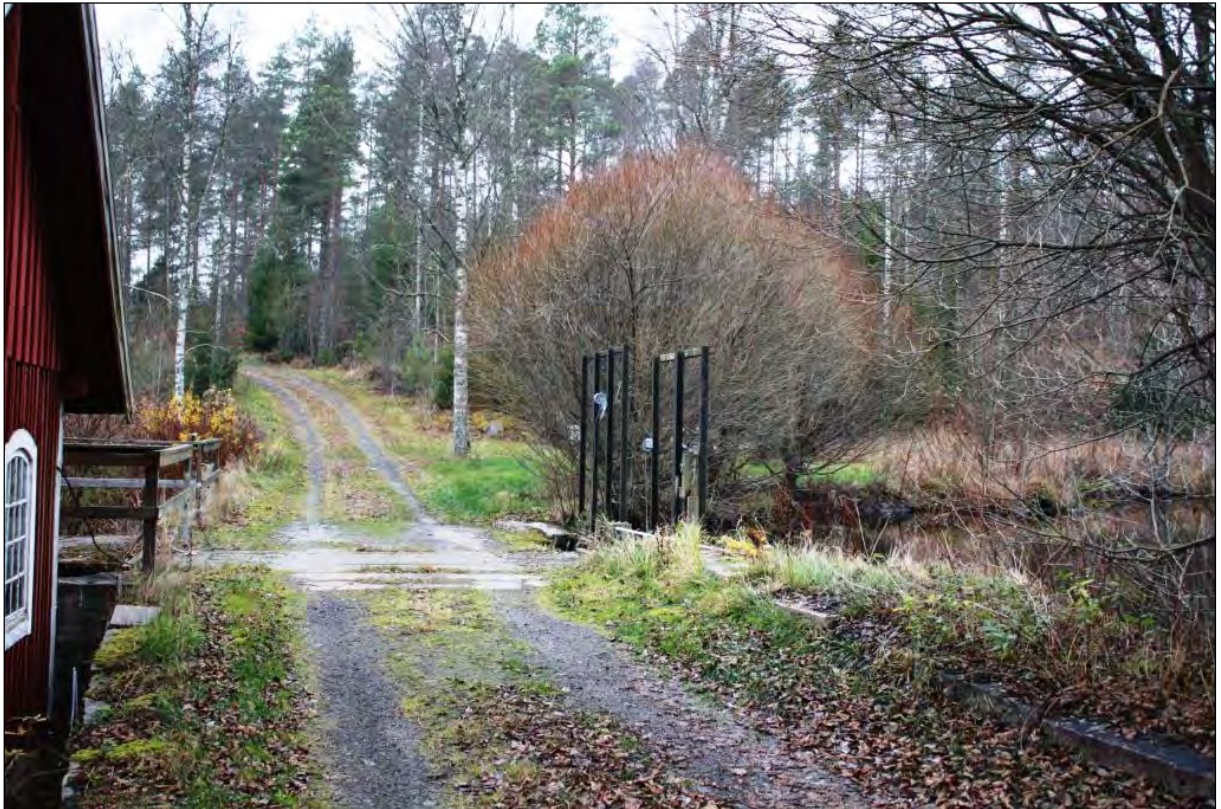
Bild 7 & 8. Intagsluckorna som reglerar vattenflödet från dammen.
