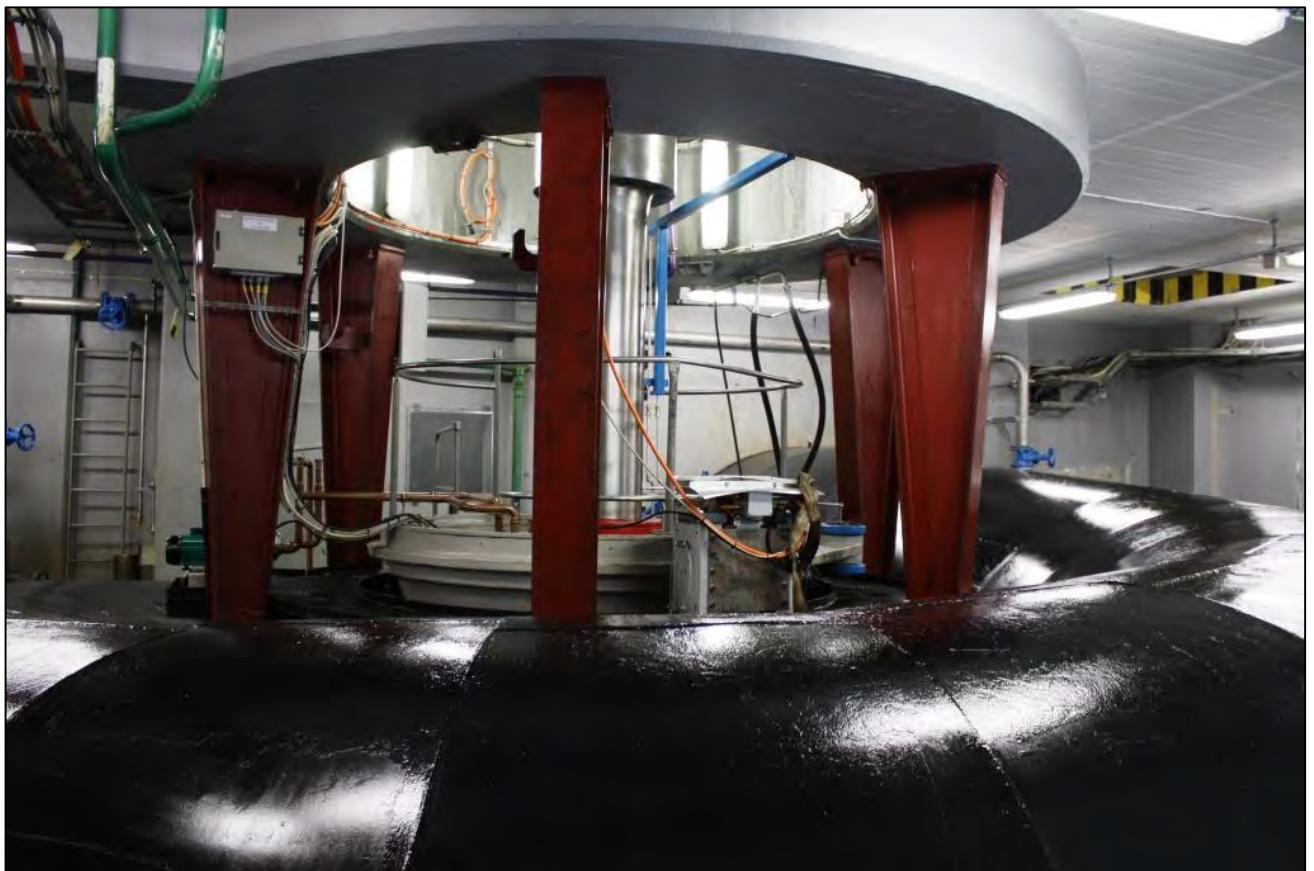
Bild 5 & 6. Vattnet färdas efter intaget i sumpen genom två sugrör och vidare genom turbinerna och ut i utloppskanalen.
