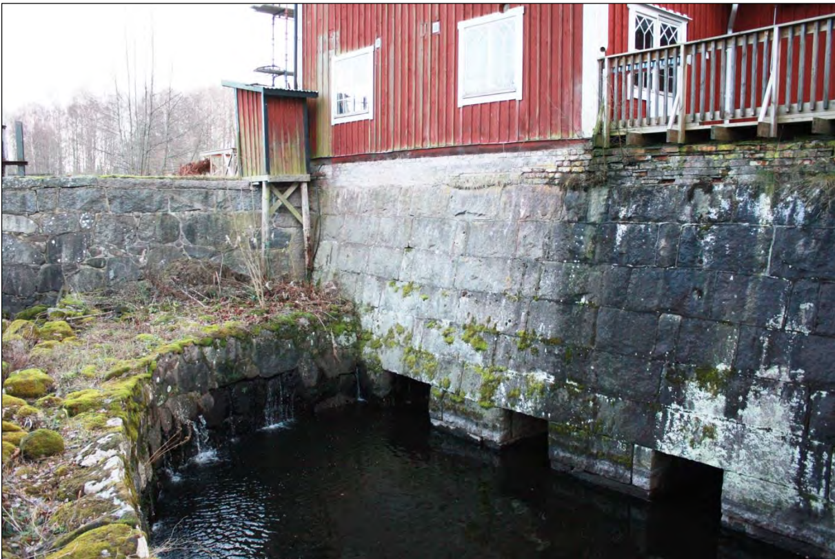
Bild 4. Den murade sockeln där vattnet tidigare kom ut efter att ha gått igenom turbinen.
