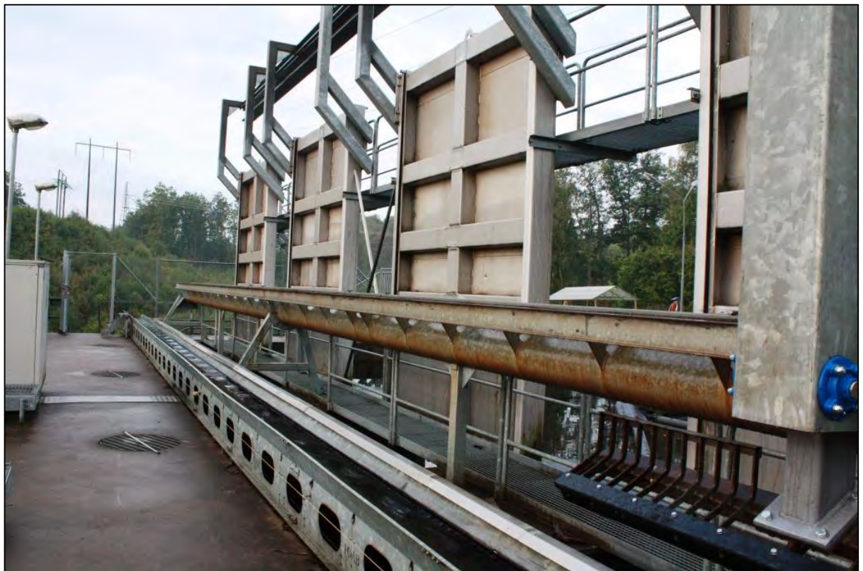
Bild 4. Utskovsluckor med ramar av galvaniserat stål och luckor i rostfritt stål.
