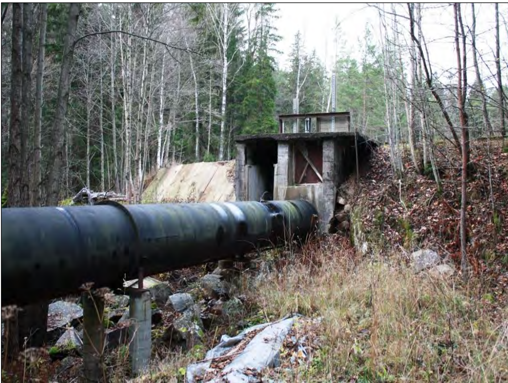
Bild 10. Röret leder vatten ner till den mindre dammen.
