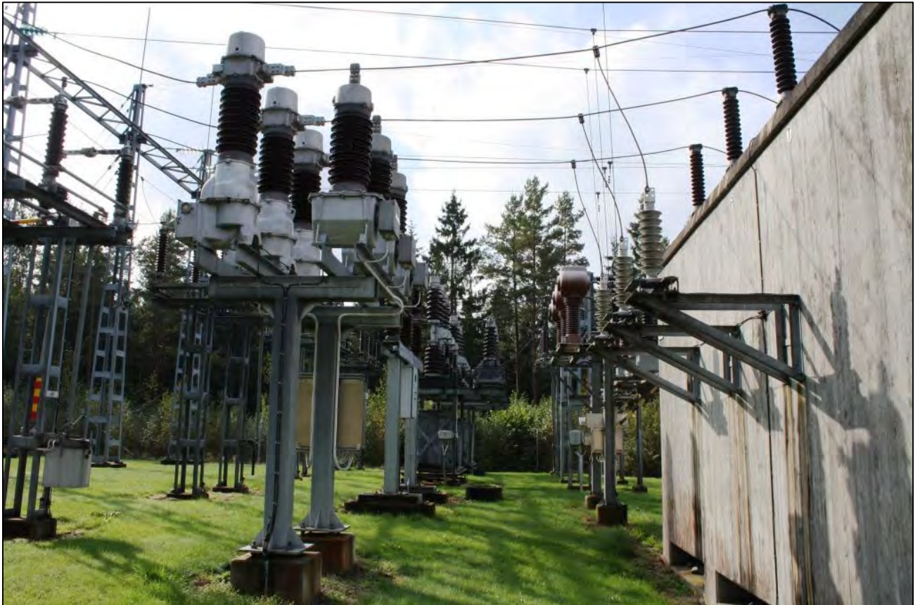
Bild 9. Eltransformatorer och ställverk i anslutning till kraftstationen.
