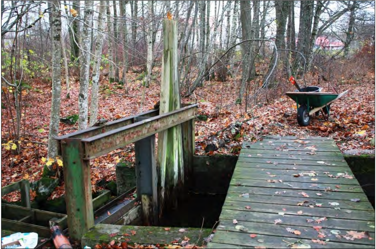
Bild 3. En spettlucka reglerar flödet i kanalen.
