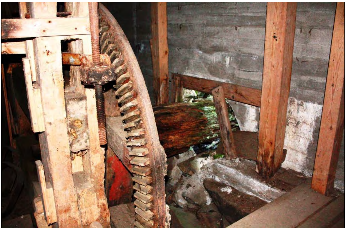
Bild 9 & 10. I byggnadens bottenvåning finns öppningar i väggen för att leda in de tidigare vattenhjulens mittstock. I den nedre bilden är detta kopplat till någon form av drivhjul.
