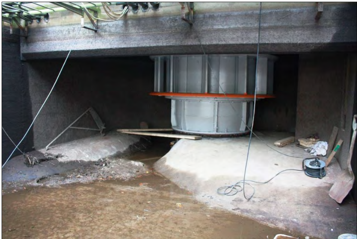
Bild 8. Betongsumpen som var torrlagd vid vårt besök p.g.a. servicearbeten med turbinerna.
