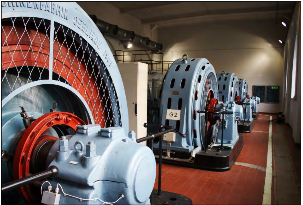
Bild 11 & 12. De fyra generatorena i kraftstationen.
