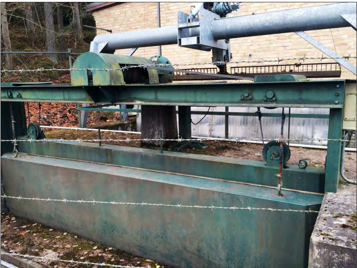
Bild 8. Planluckan som reglerar vattenintaget till turbinen.
