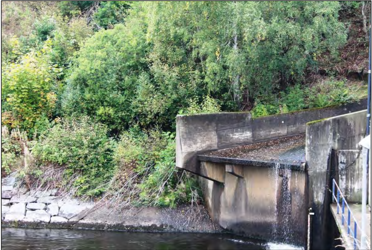
Bild 3. En sidoränna av betong som är till för att avleda packis.
