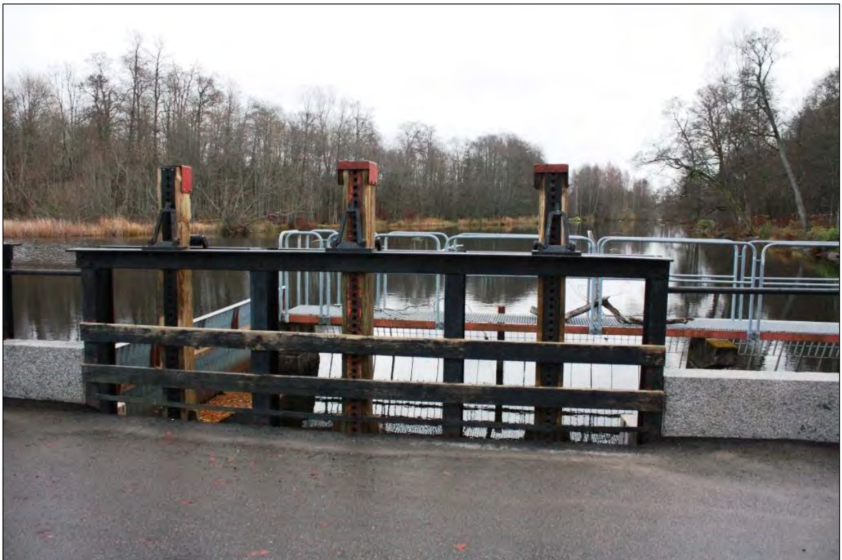
Bild 5 & 6. Dambyggnaden med ett flertal utskovsluckor.
