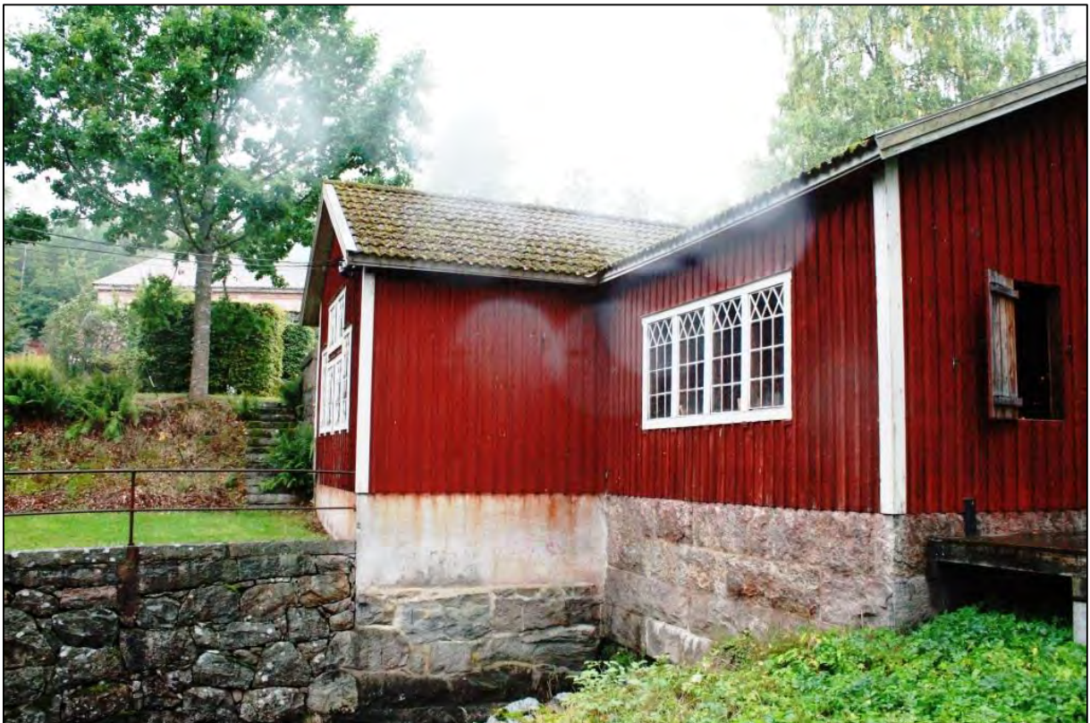
Bild 8. Utloppet vid kraftstationen. Kanalen är uppförd i vällagd tuktad sten för att bakvattnet snabbare ska ledas bort.
