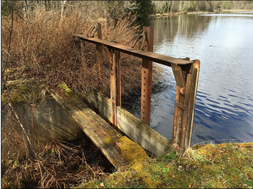
Bild 5. Intaget som reglerade betongsumpen, med två spettluckor.
