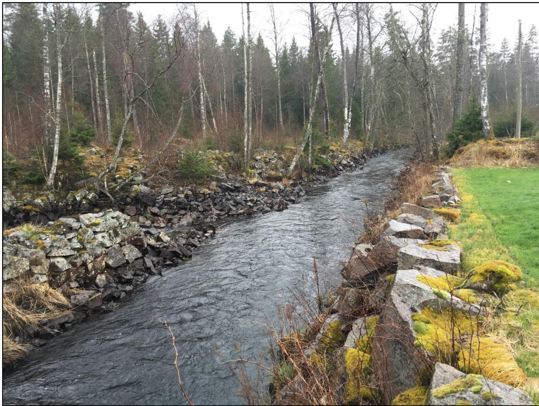
Bild 7. Utloppskanalen är tydligt rensad på sten och dess kanter är längs vissa partier stenskodda.
