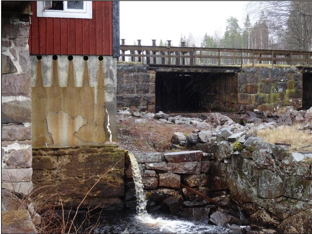
Bild 5. Turbinsumpen med öppningar för vatten överst närmast panelen.
