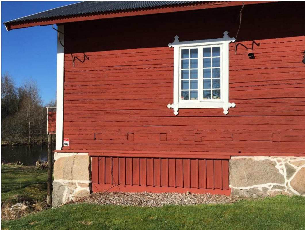
Bild 3. I fasaden syns spår av en tidigare öppning för intag till turbinen.
