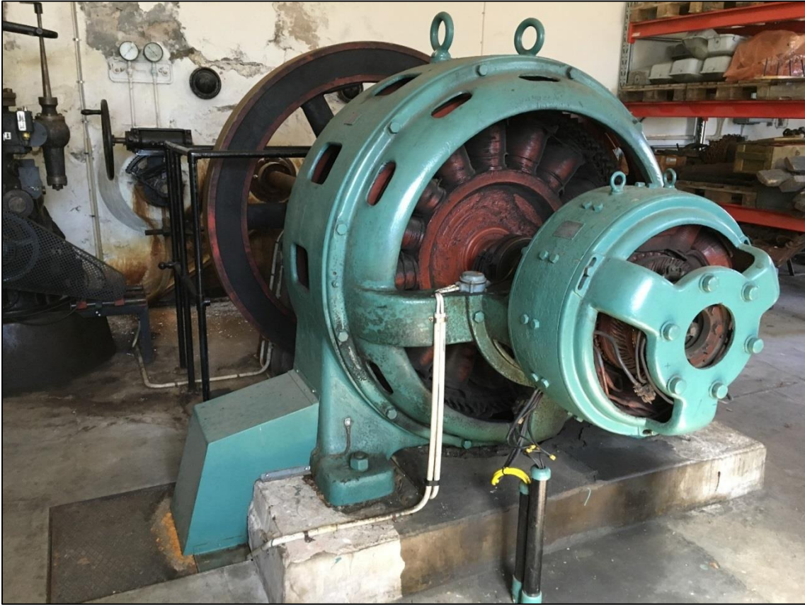
Bild 3. Generatorn inne i kraftstationen.
