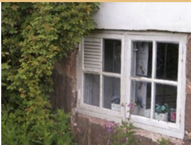
Rosor vid källarfönster
